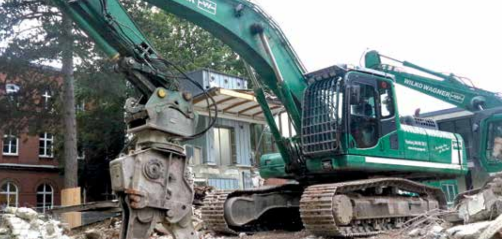
Ganze Arbeit leisten die Bagger, die das Baufeld im östlichen UKE-Bereich freiräumen
